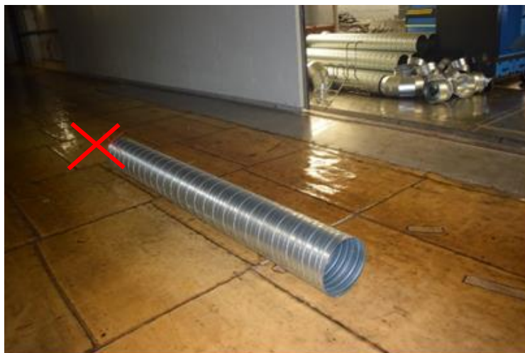
5.9.2-5 pav. Įvykusio incidento vieta
