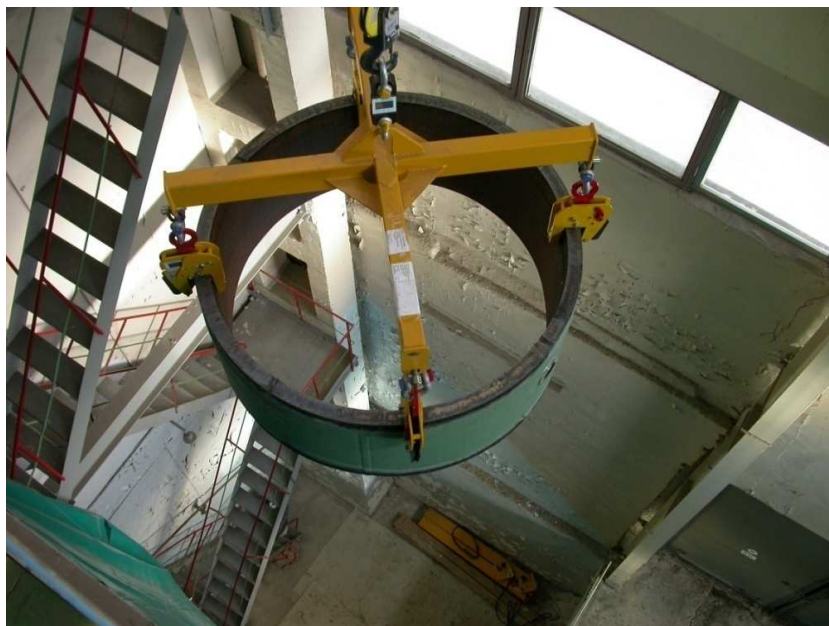
2.1-5 pav. RAAS HB nupjauto segmento perkėlimas (pirmojo energijos bloko RAAS HB išmontavimas)
